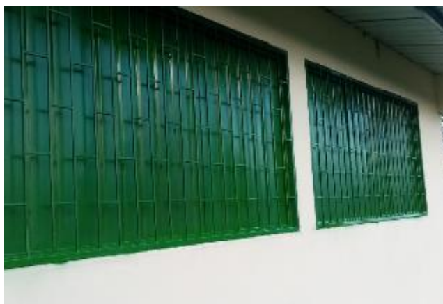
Foto 5. Pintura externa en muros y ventanas
